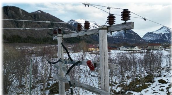
Inspeksjonsbilde av høyspentlinje tatt med drone.
